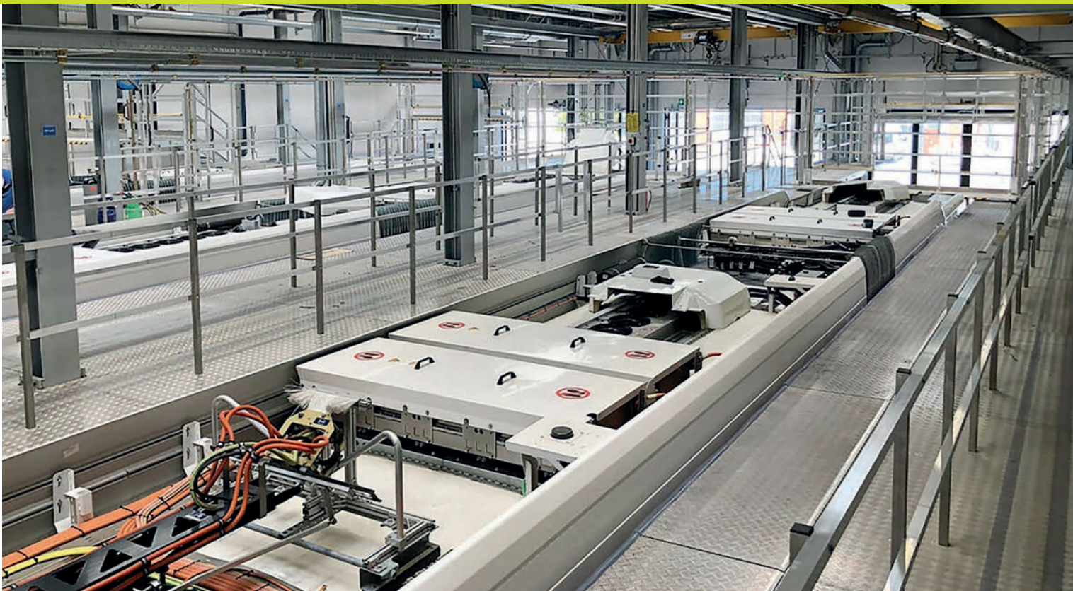
Ansicht der Elektro-Komponenten auf dem Dach eines Elektrobus-Gelenkzuges.
